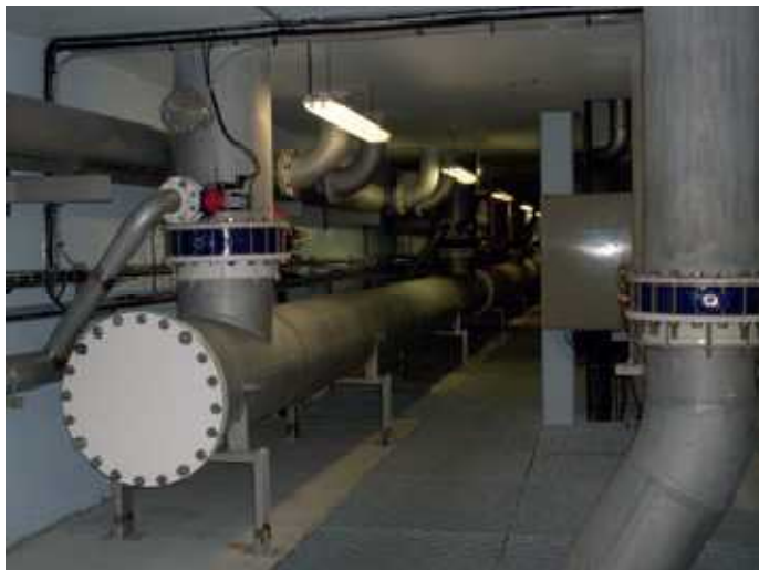
액체와 기체의 유입 및 액체 유출과 생물학적 처리를 위한 배수관 (프랑스 Annemasse-Les Voirons)
