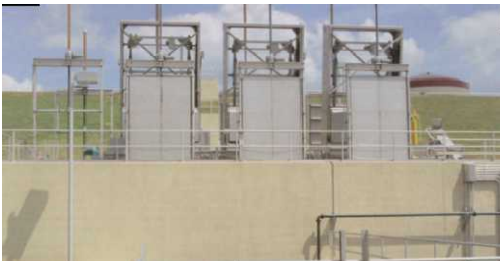
두 개의 오수 계류장 사이 스테인리스스틸 슬라이드 게이트. 캐나다 토론토
